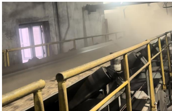
图4.3-2输煤皮带现场图
